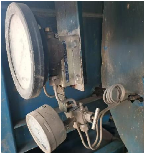
图 5 原焊接高压管路
